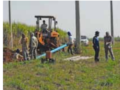
Canalização de Água
