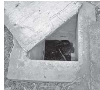
Esgoto do canil
